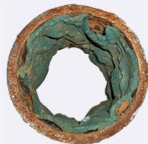
Abbildung 3: Beispiel einer unzureichenden Innenbeschichtung in einer Trinkwasser-Leitung
