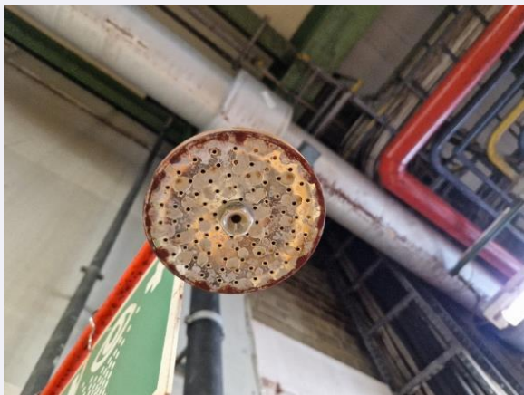
Abbildung 6: Entnahmestellen an Sicherheitsnotduschen müssen regelmäßig inspiziert und gereinigt werden, da Verunreinigungen aus der Entnahmestellen zu schweren Verletzungsfolgen führen können; Quelle: DVQST e.V.
