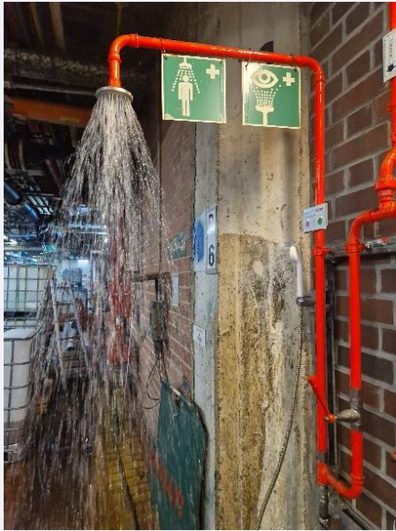
Abbildung 8: Körpernotduschen sollen alle Körperzonen sofort mit ausreichenden Wassermengen überfluten können, hierfür sind mindestens 30 l/min für mindestens 15 Minuten erforderlich
